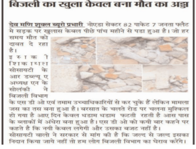
बिजली का खुला केबल बना गैर का अड्डा
